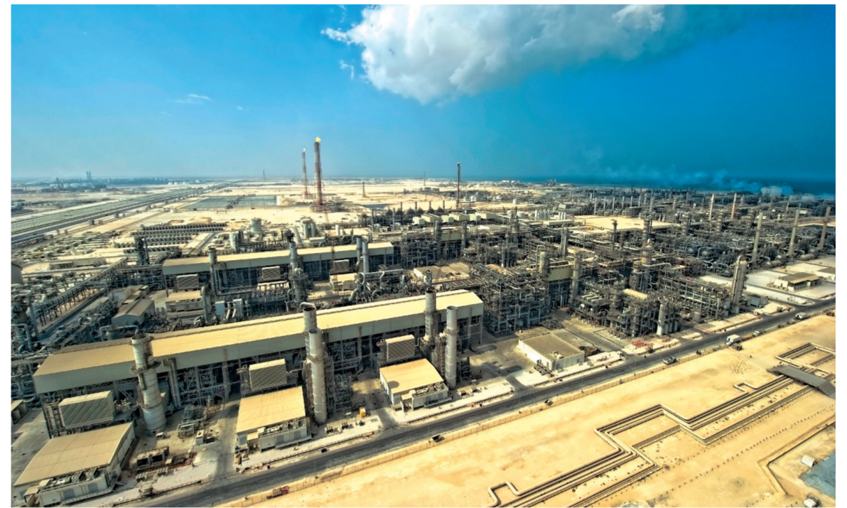
Qatargas LNG plant Courtesy of Qatargas
